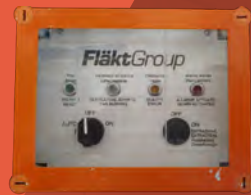
Pannelli di controllo
